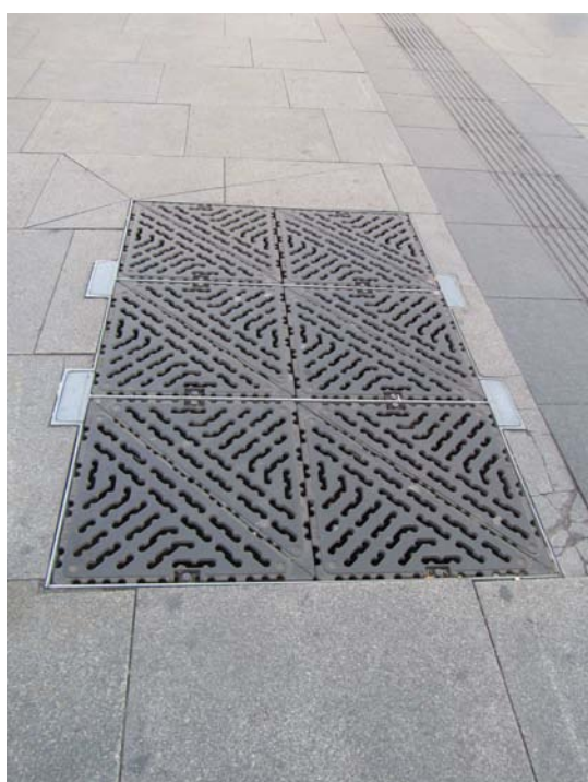
Imagen 13. Detalle de rejilla accesible ubicada en itinerario peatonal accesible cumpliendo con las dimensiones mínimas. Diseño Metro de Madrid.
