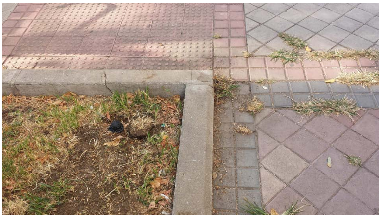
Imagen 11. Las inmediaciones de los parterres y alcorques son zonas muy proclives a la proliferación de vegetación en las juntas del pavimento que deben controlarse.
