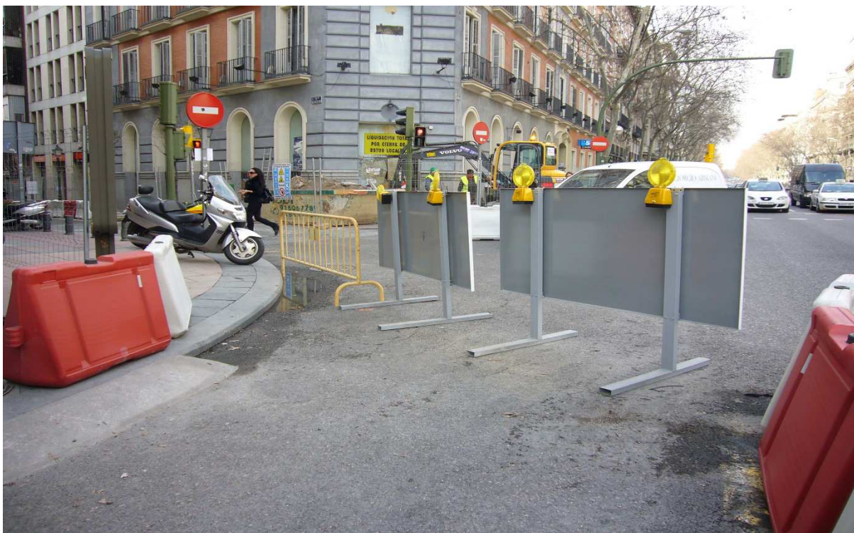
Imagen 05. Balizamiento luminoso en vallado provisional. La falta de unión entre los elementos (vallas, paneles direccionales, etc.) los hacen susceptibles de ser desplazados o volcados por la acción del viento o manipulación de terceros
