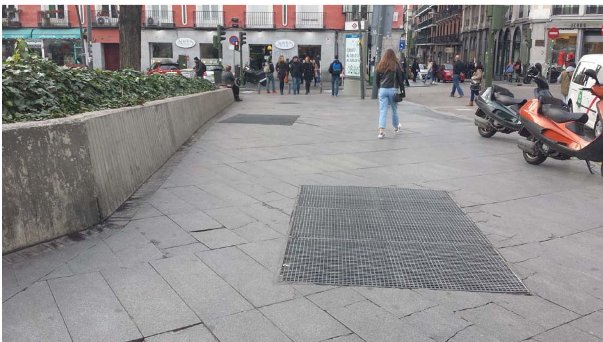
Imagen 13. Rejilla de ventilación de Metro en la plaza de Tirso de Molina. Es habitual que en plazas de cierto tamaño se dispongan rejillas en los recorridos accesibles, que por lo tanto deberán garantizar una trama de no más de 1 cm de apertura en ambas direcciones.
