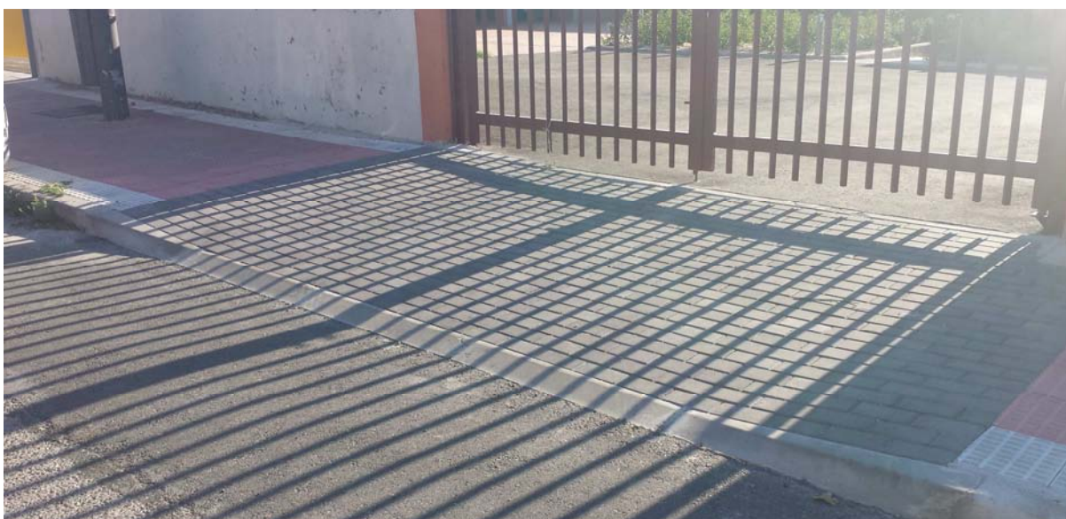
Imagen 08. Formación de un vado de vehículos en acera estrecha con cambio de pavimento
