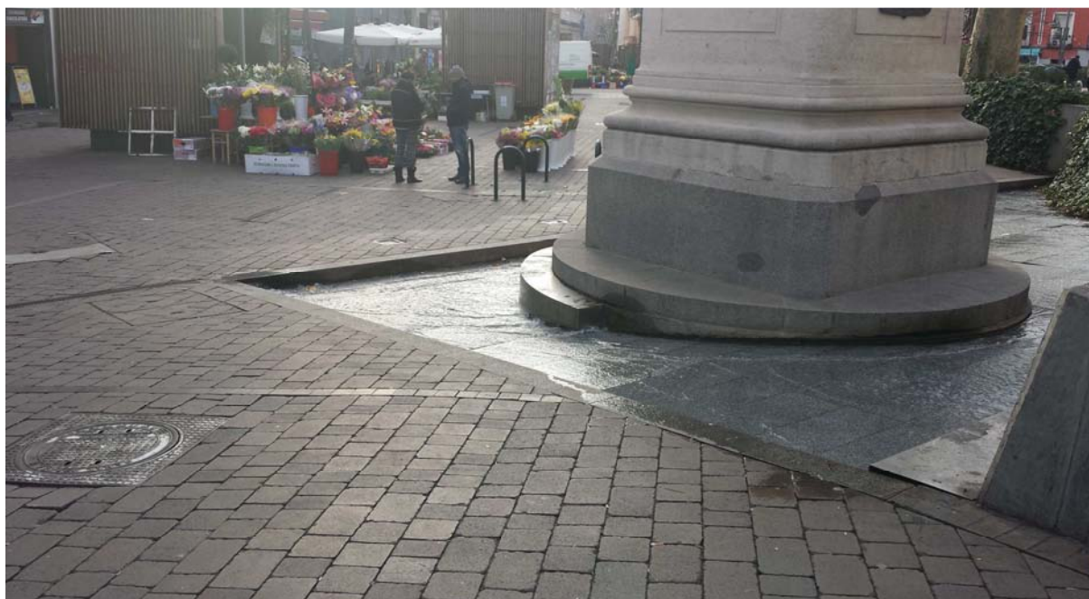
Imagen 16. Lámina de agua sin protección en la Plaza de Tirso de Molina. Este tipo de situaciones deben evitarse ya que generan situaciones de peligro a cualquier viandante, pero en especial a los que presentan algún tipo de discapacidad visual.
