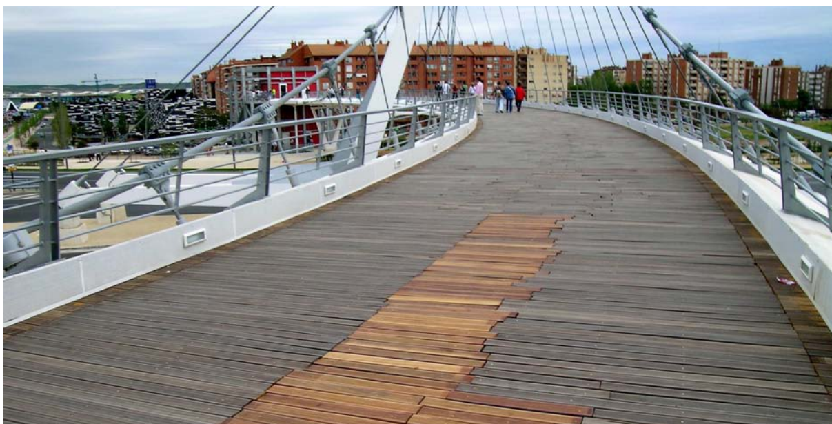
Imagen 10. Pasarela peatonal en Zaragoza. En estos casos la rápida respuesta de los servicios de conservación es fundamental para evitar accidentes
