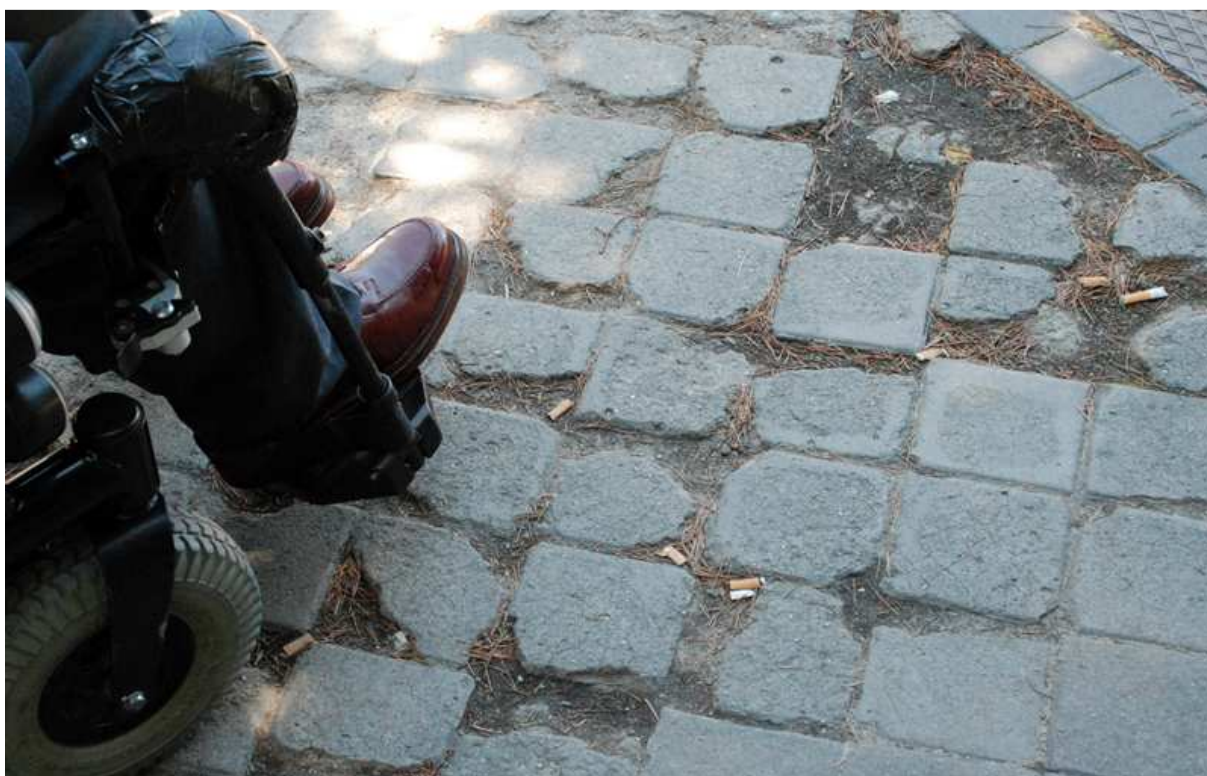
Imagen 01. La falta de mantenimiento y reposición del pavimento afecta a sus condiciones de accesibilidad, favoreciendo tropiezos y dificultando el tránsito de usuarios de sillas de ruedas.
