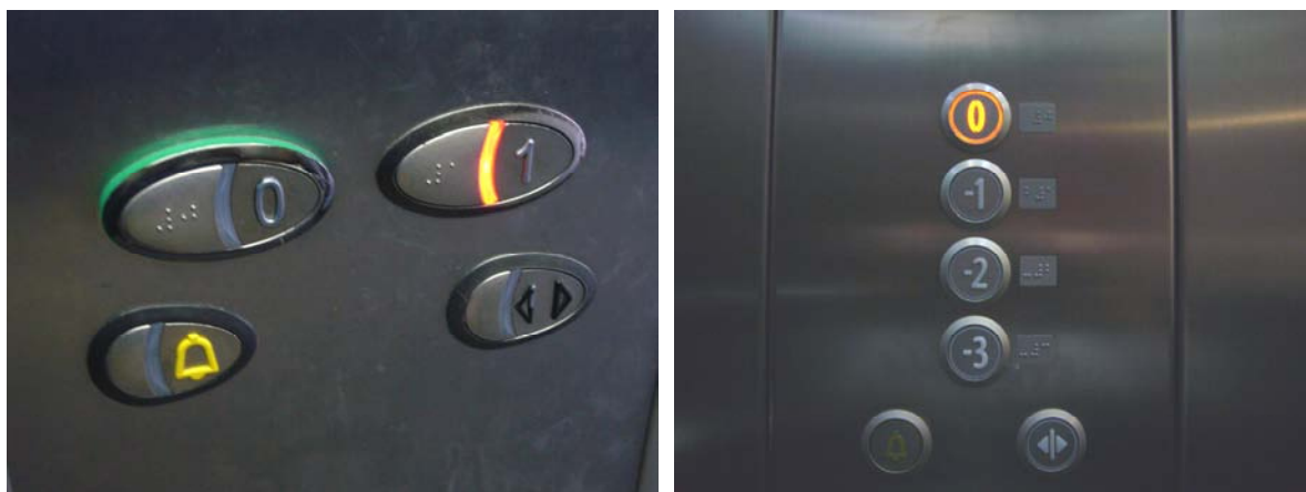
Imagen 08. Botoneras en el interior de la cabinas
