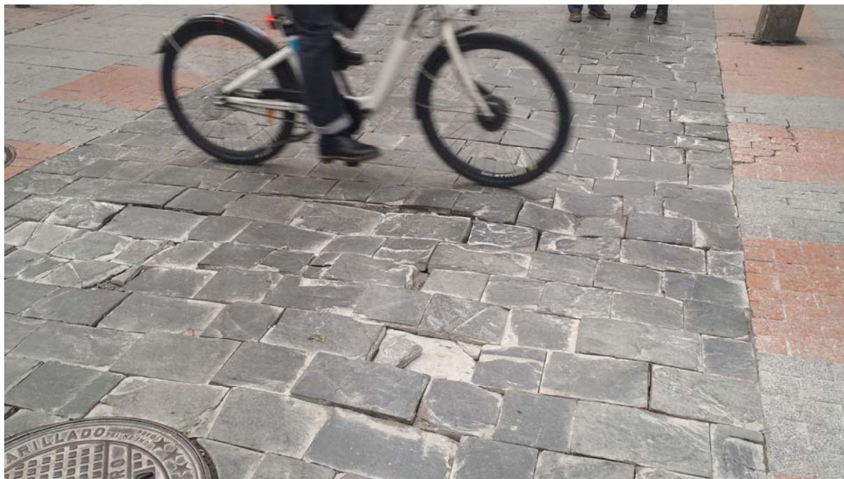
Imagen 03. En la imagen el deterioro del pavimento conlleva situaciones de tropiezo y limitaciones para el uso de cualquier vehículo de ruedas.
