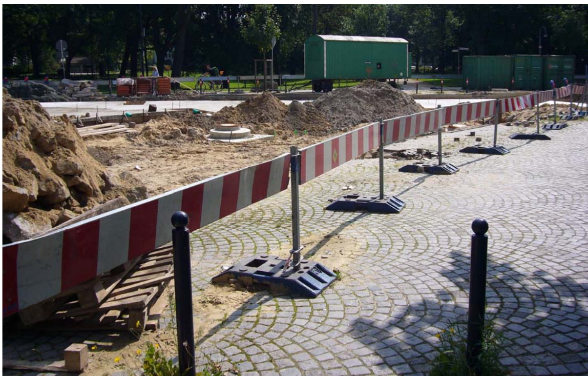
Imagen 02. Protección de zona de obras mediante vallado provisional. Los soportes de las vallas parecen sólidos sin embargo el hueco permite el acceso de un niño a la zona de obra
