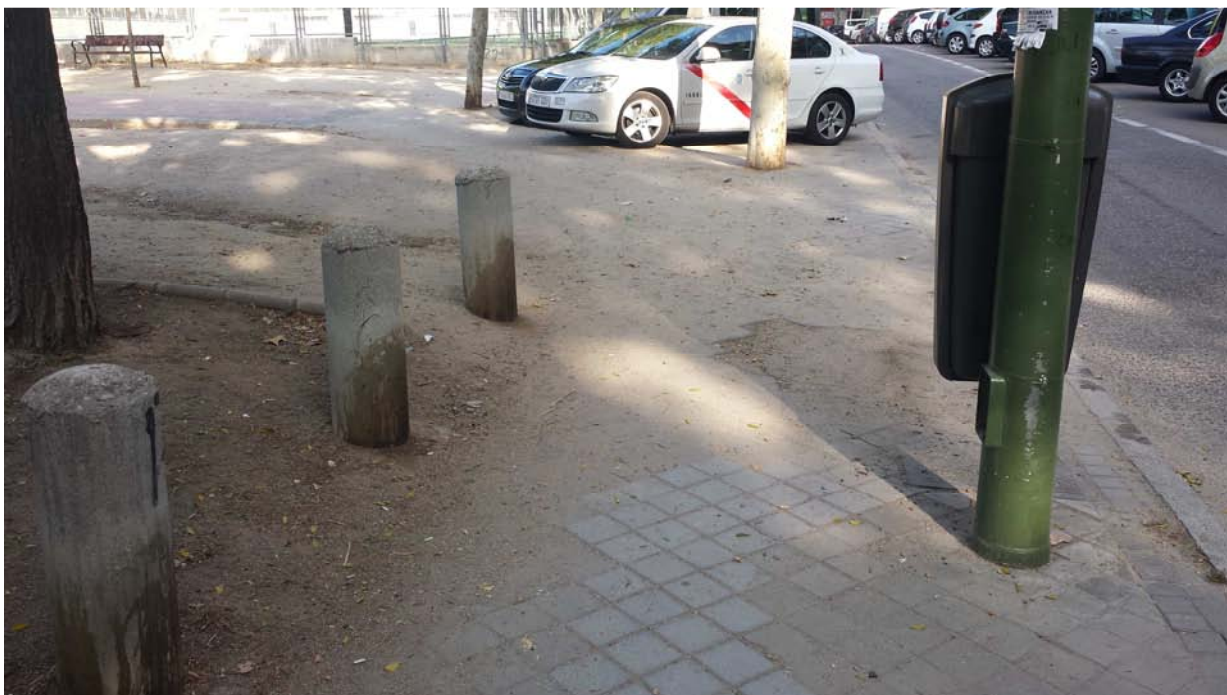
Imagen 12. En la imagen se muestra como las aguas de lluvias han depositado parte de las tierras del parque anexo en la acera, que por falta de limpieza llega a desaparecer.
