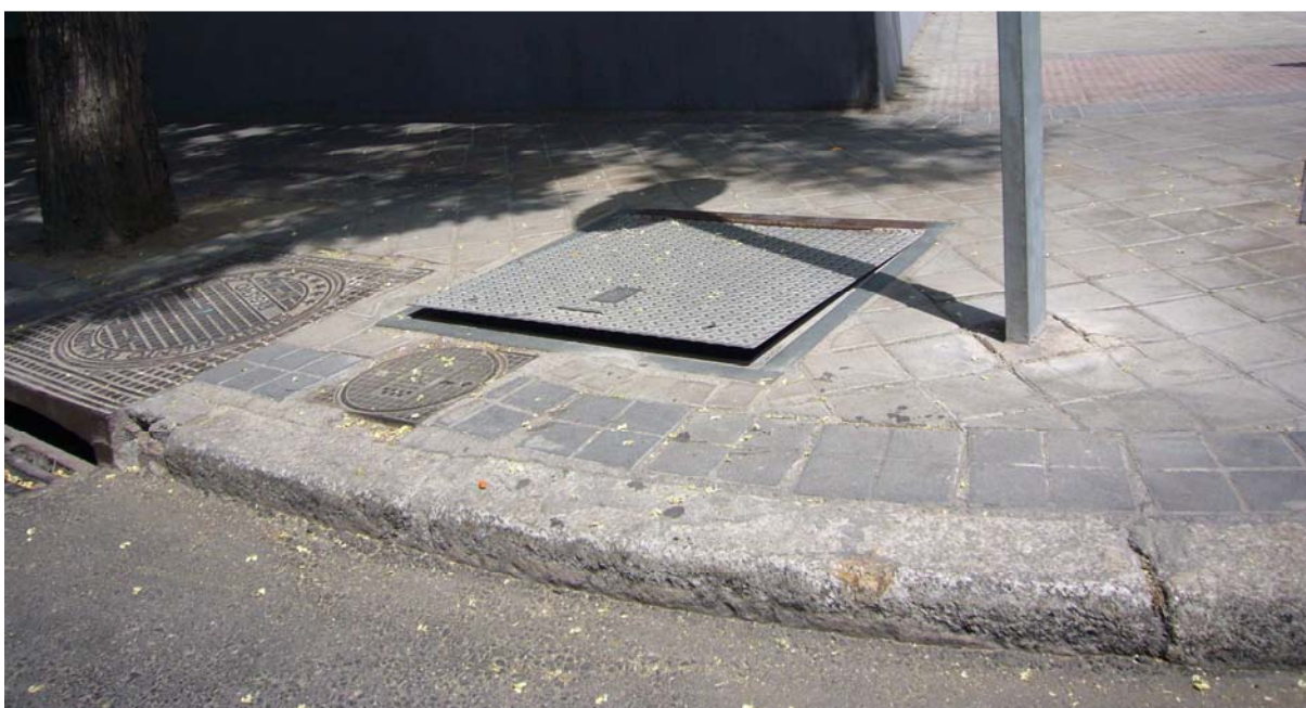
Imagen 07. Tapa de registro sin cerrar que produce un resalte en el pavimento de la acera
