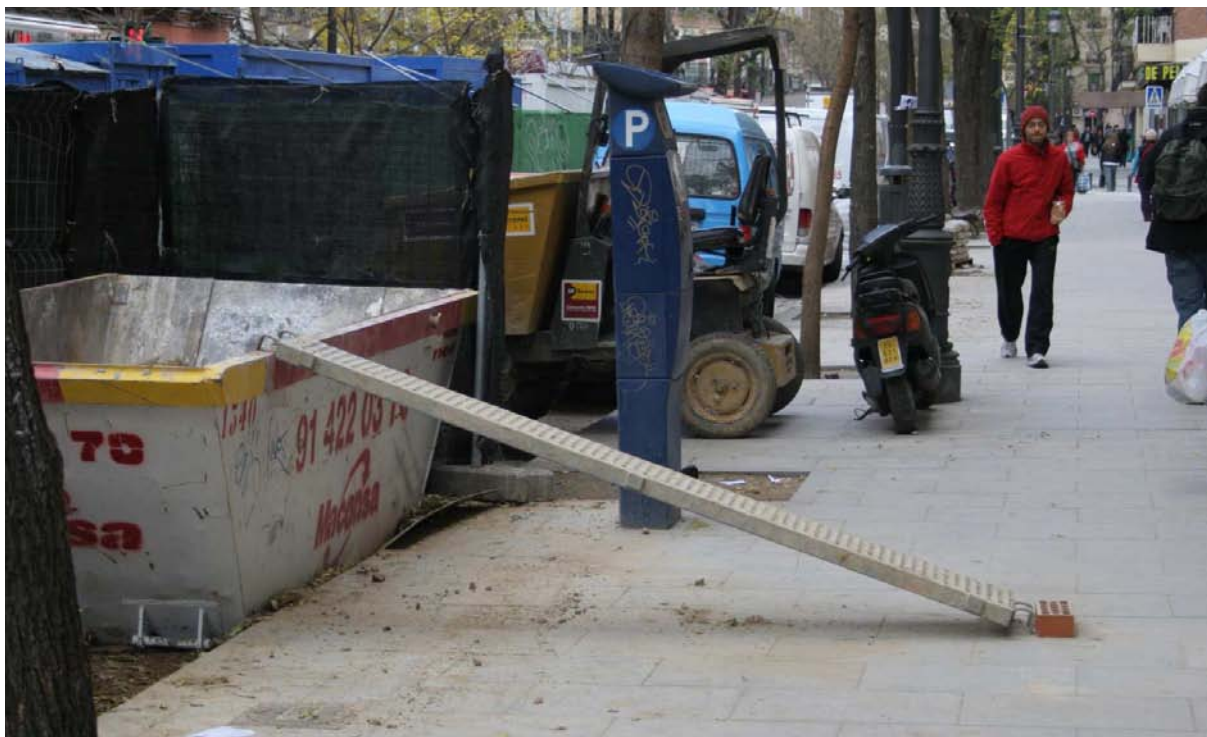
Imagen 09. Incluso cuando los trabajos sean de carácter temporal no se interrumpirá su correcta señalización y las pertinentes medidas de seguridad que eviten accidentes en la vía pública. La imagen muestra una evidente situación de riesgo para las personas
