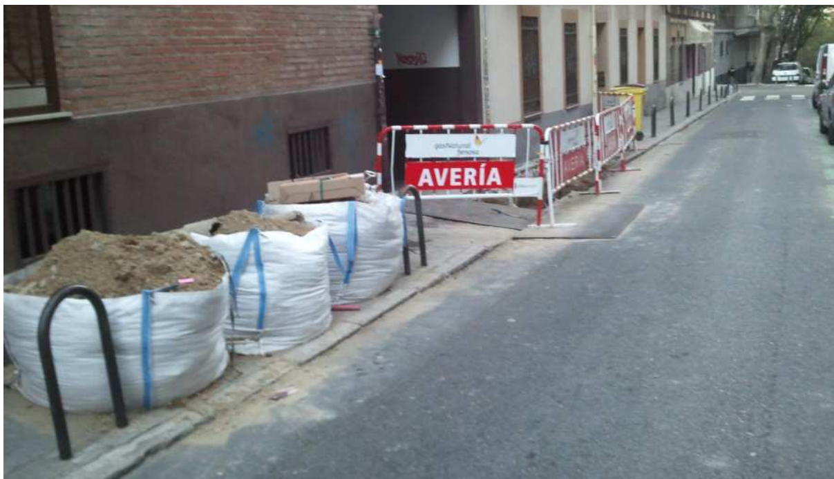
Imagen 06. Los acopios de material deben realizarse fuera del itinerario peatonal de las aceras y protegidos en todo su perímetro (lo que no ocurre en la imagen)
