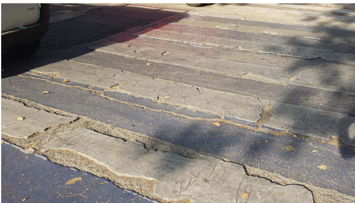
Imagen 13. Deterioro de la pintura de cebreado del paso de peatones generando multitud de resaltes y hundimientos que deben corregirse.
