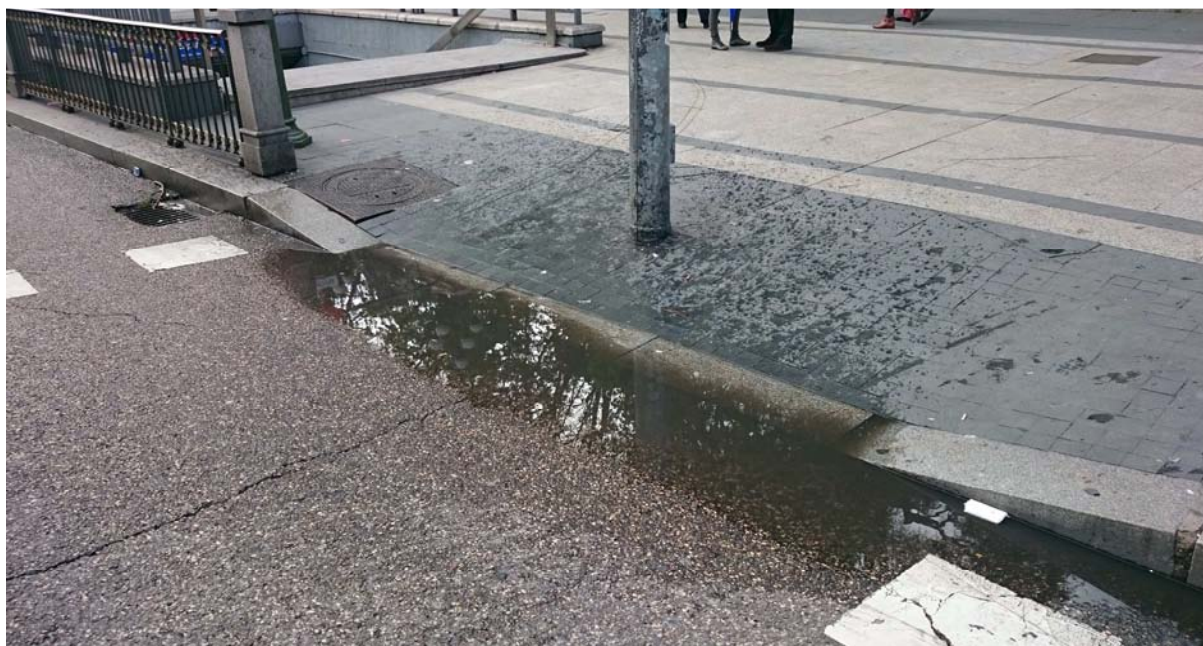
Imagen 13. Problemas de encharcamiento producidos por una ejecución deficiente del encuentro vado-calzada en la calle de Alcalá
