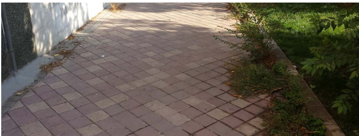
Imagen 04. Parterre ajardinado en cuyo límite proliferan de forma descontrolada raíces y matorrales, conllevando un deterioro del pavimento circundante.
