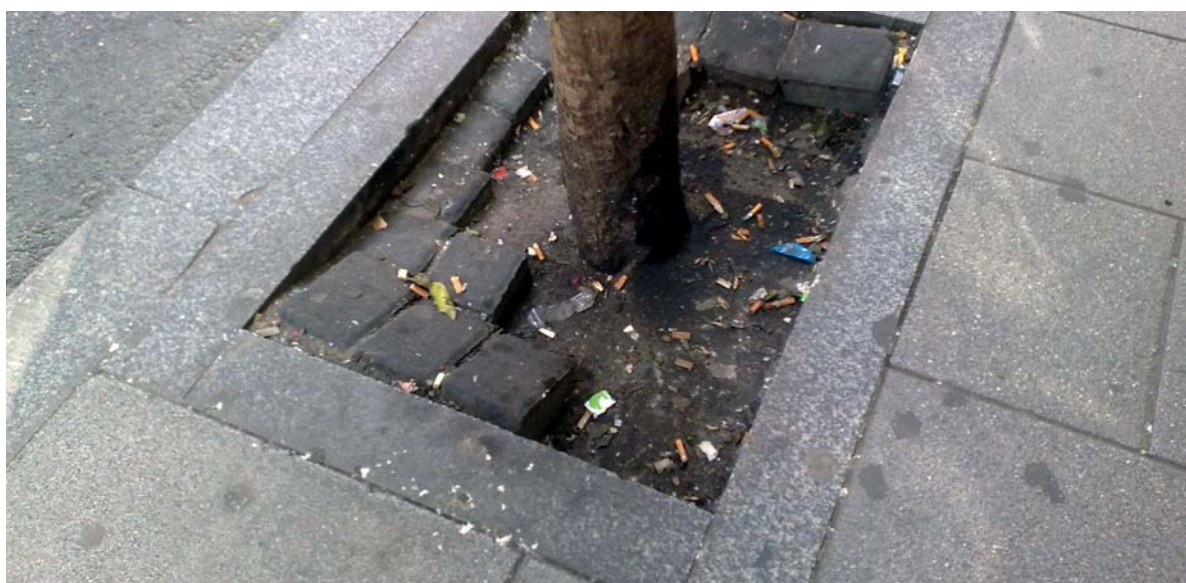
Imagen 05. La pérdida de árido en el alcorque conlleva el hundimiento del adoquín y posteriormente la pérdida de piezas, generando un desnivel no previsto que debe corregirse.
