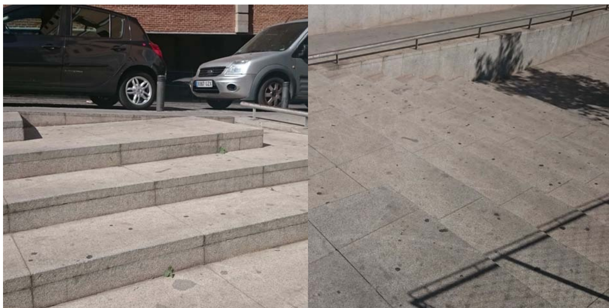
Imagen 06. "Efecto rampa" en una escalera en la calle de Almadén. La falta de señalización de los escalones provoca distintos efectos visuales en la misma escalera
