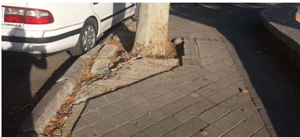
Imagen 06. Efecto del crecimiento de las raíces del arbolado en su entorno, con rotura del alcorque y deterioro del pavimento circundante.
