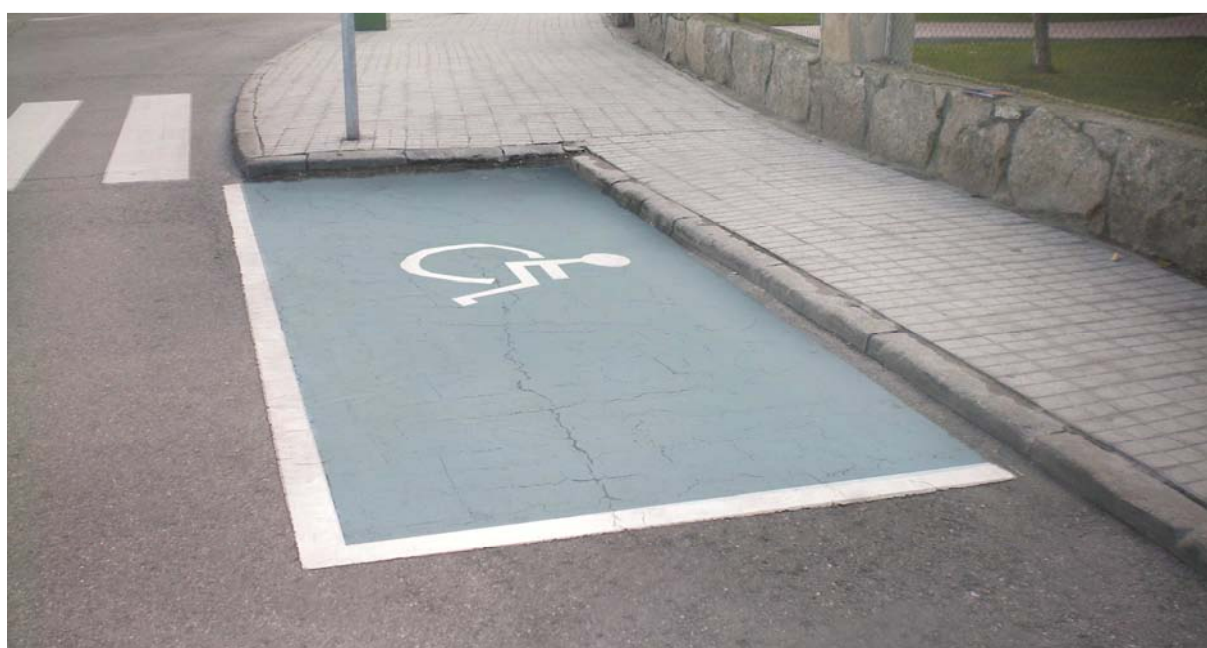
Imagen 07. Mal diseño: plaza reservada de dimensiones insuficientes, sin conexión con el itinerario peatonal y con descenso del conductor sobre el carril de circulación de vehículos
