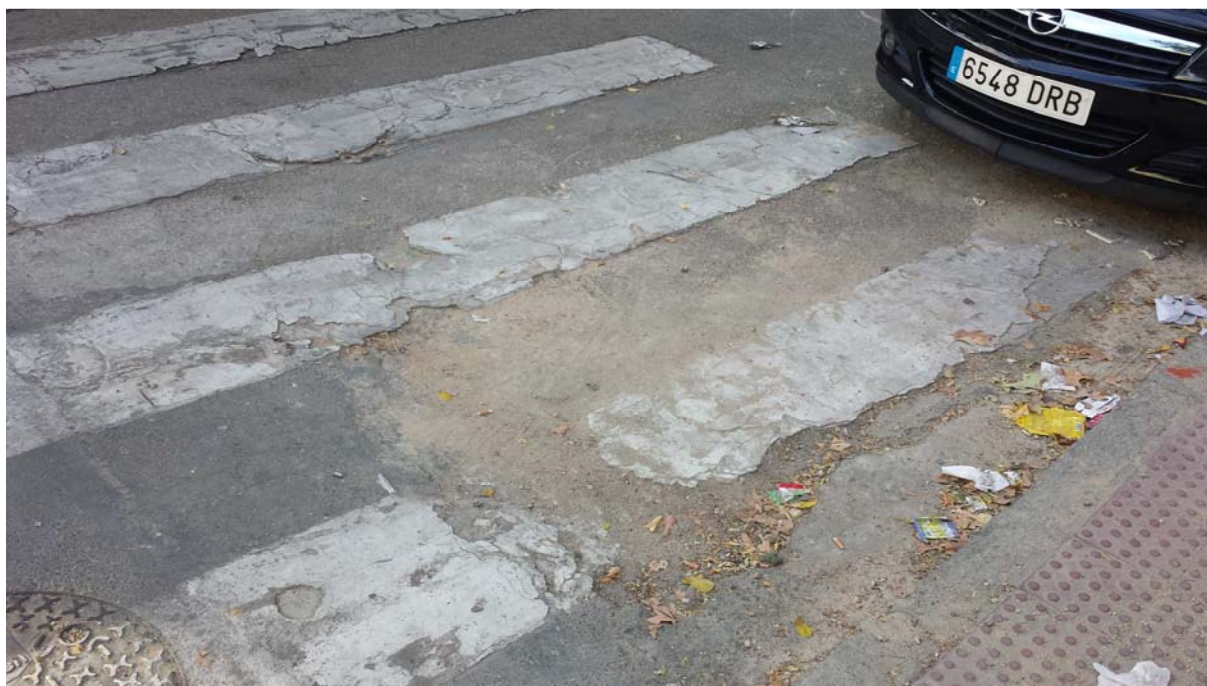
Imagen 10. Pintura y firme deteriorado en el cebreado del paso de peatones
