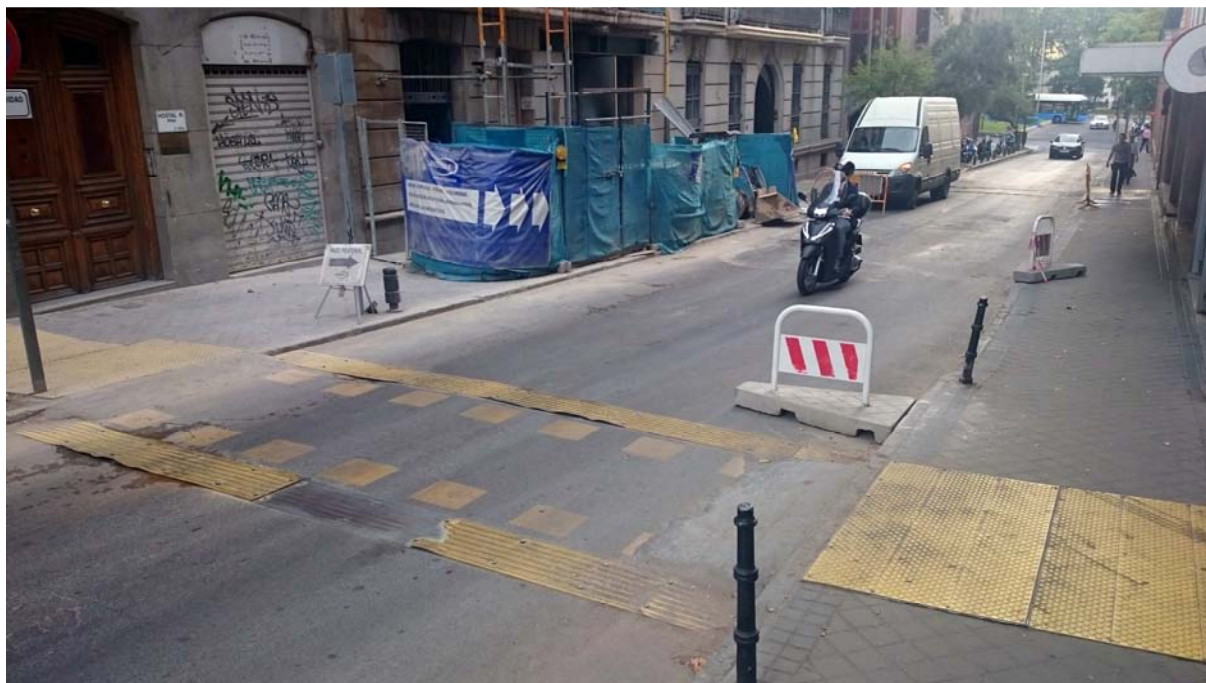
Imagen 12. Desvío provisional del itinerario peatonal con paso de peatones provisional por ocupación de acera
