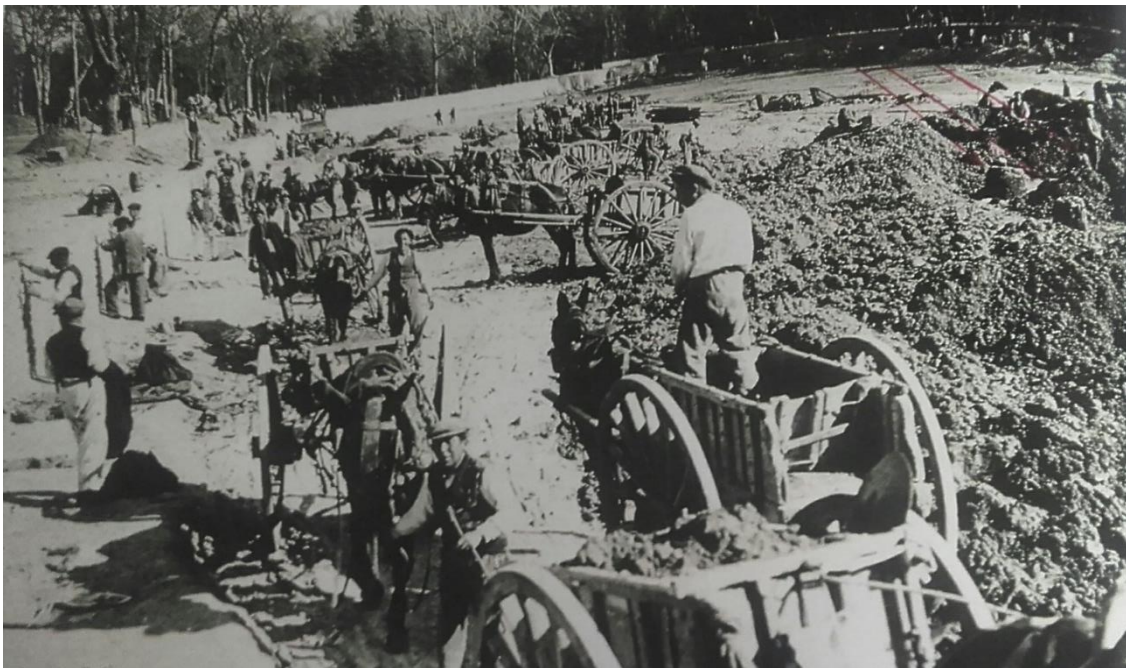
Trabajadores en la Casa de Campo en tareas de limpieza del lago. Destacar a la izquierda de la misma, las labores de consolidación de la cubeta y de la ampliación de la misma, que llegó a duplicar su tamaño.
