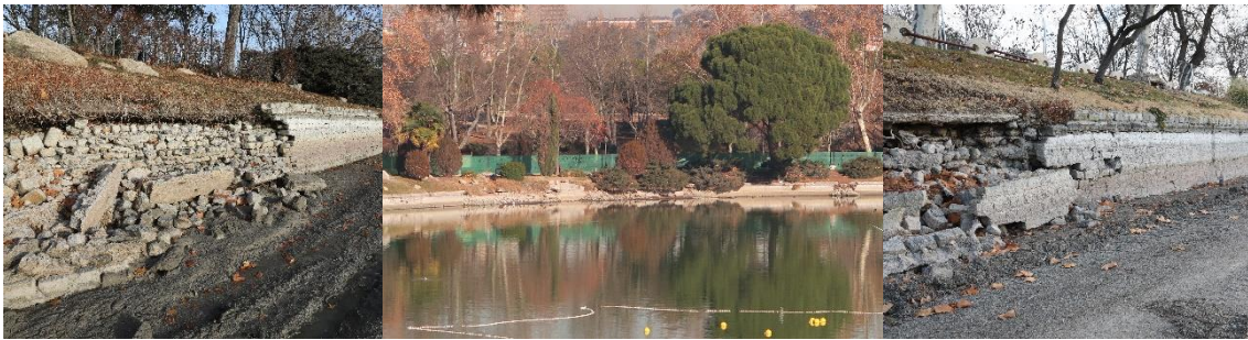
Desperfectos del muro perimetral del Lago, antes de la remodelación de 2018.
